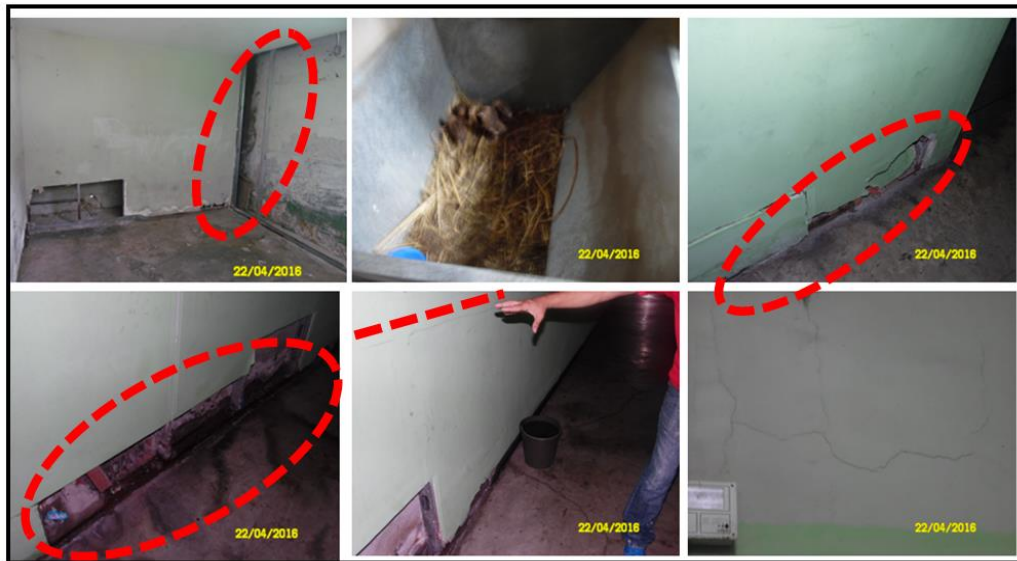
Gráfico 43. Vista de los espacios interiores de la Posada de Catia en la actualidad. Deterioro de las paredes de drywall a causa de la humedad por filtraciones de aguas de lluvia y servidas. También se puede apreciar como los ductos del aire acondicionado fueron desinstalados para adecuar nidos para la cría de codornices dentro del refugio.
