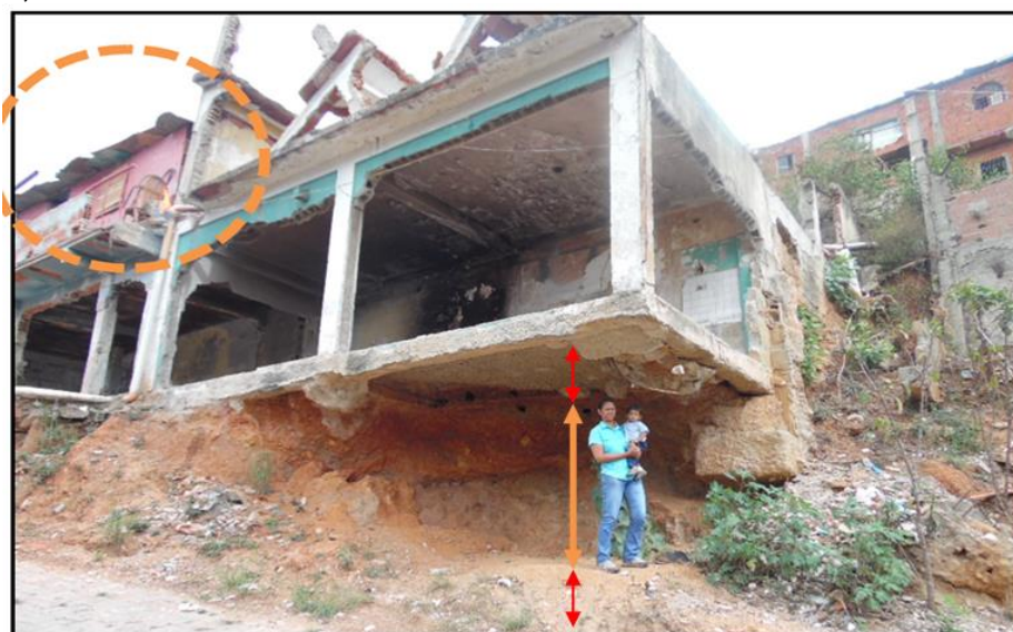
Gráfico 18. Vista de la habilitación de las casas afectadas por las lluvias de 2010, en el sector Federico Quiroz, Catia, Parroquia Sucre, Distrito Capital. Marcano, abril de 2016. Nota: la circunferencia naranja muestra el área de vivienda rehabilitada.
