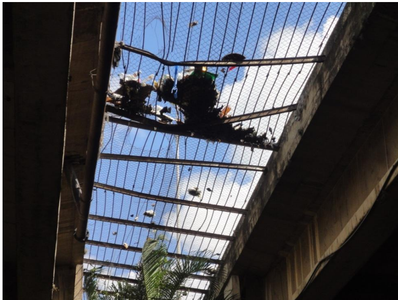
Gráfico 7. Acumulación de basura en malla de seguridad.
