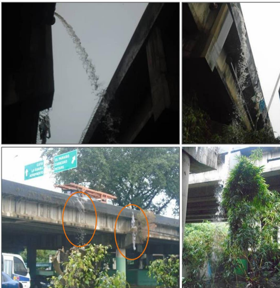
Gráfico 5. Caída de agua de lluvia desde el Distribuidor la Araña.
