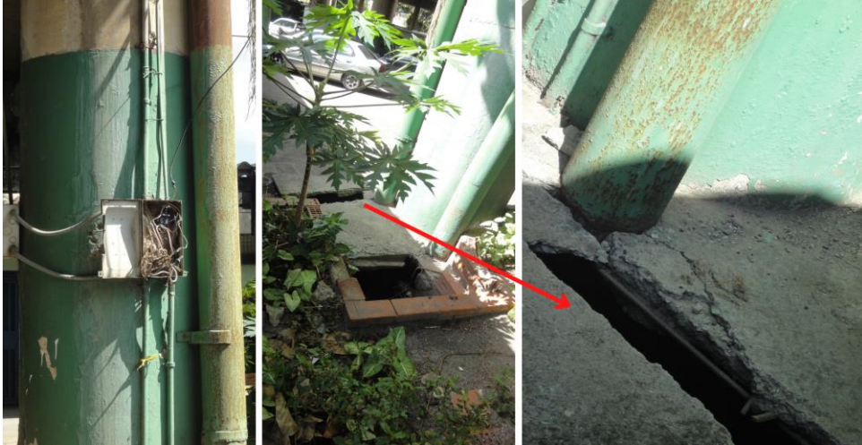
Gráfico 10. Tablero eléctrico en condiciones inseguras, socavamiento en bases y raíces de árbol colgando.
